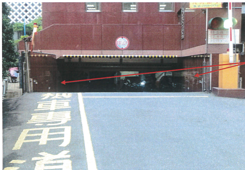
車道左右側紅框範圍內石材 外牆矽利康割除更新 (DOWSIL991 材料)
